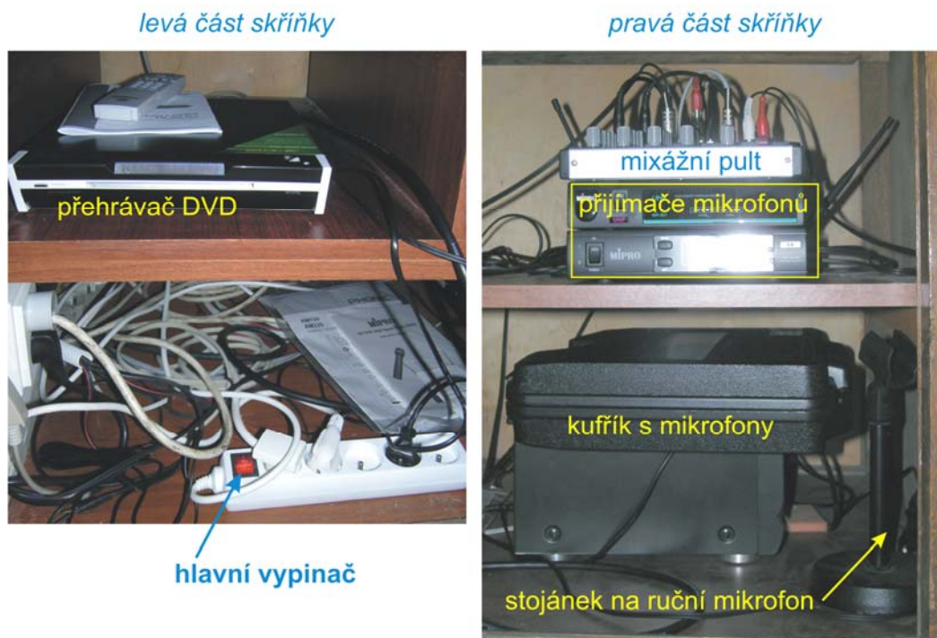
Obr. 1. Umístění zvukové aparatury v posluchárně A II
